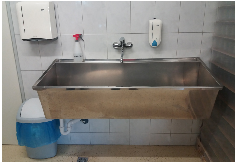
Abb. 09 - Spülwanne mit fließend Warm- und Kaltwasser
